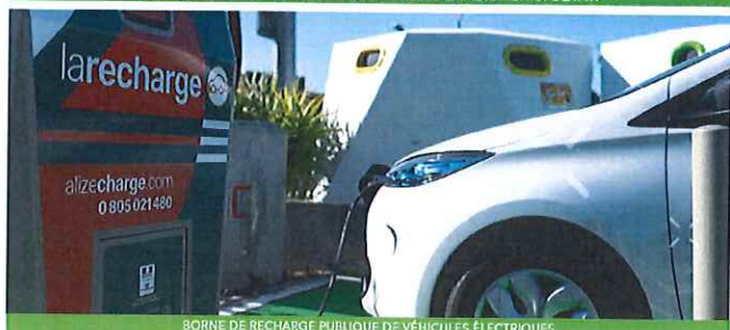
BORNE DE RECHARGE PUBLIQUE DE VÉHICULES ÉLECTRIQUES
